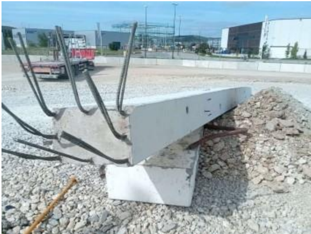
SITUACIÓN DEL PILAR Y EL MUERTO TRAS LA CAÍDA DEL PILAR
