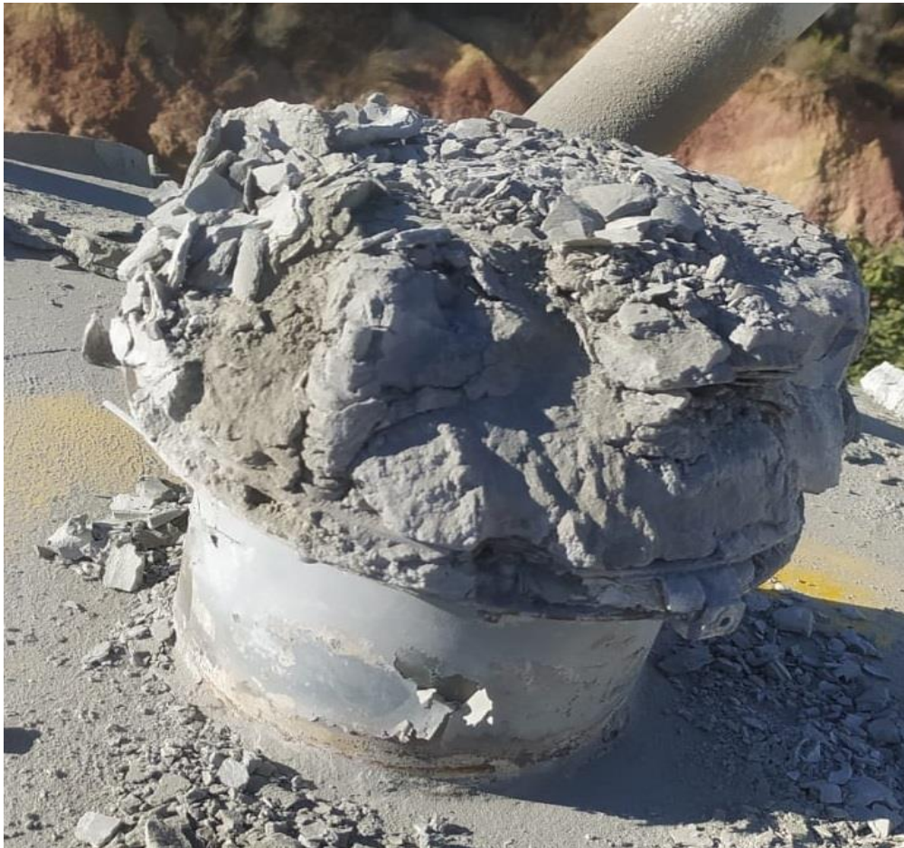
VALVULA DE SOBREPRESIÓN CEGADA NO VISIBLE DESDE ABAJO
