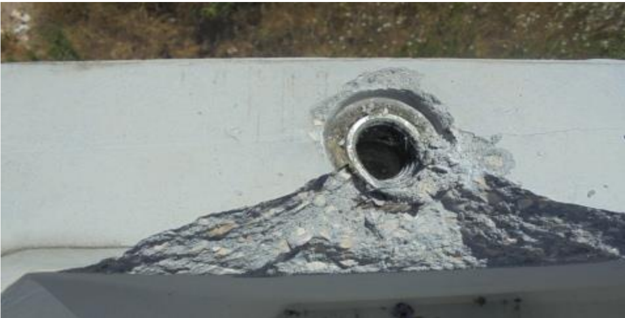
IMAGEN ANCLAJE DEFORMADO POR EL EFECTO CITADO
